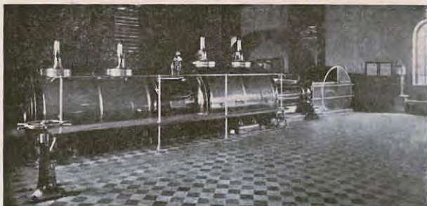
Abb. 51. Ventilator-Antriebsmaschine in Tandem-Anordnung auf Schachtanlage 3/5.
