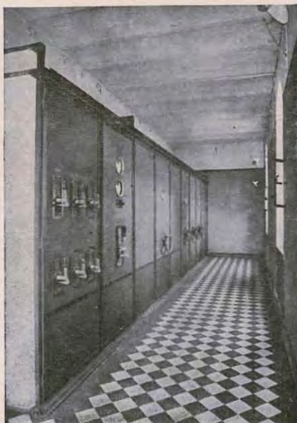
Abb. 62. Schaltanlage der Unterstation auf Schachanlage 3/5.
