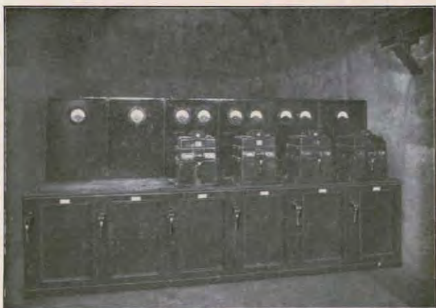
Abb. 48. Schaltanlage der neuen elektrischen Wasserhaltung unter Tage auf Schacht 2/6.
